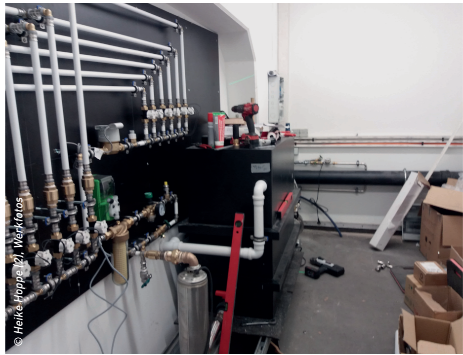
Technikraum mit Zisterne für die zentral gesteuerte Bewässerung.
